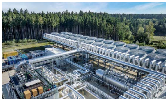
Geothermie installatie in het groen, Duitsland
